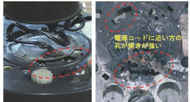
写真10 焼きする前の孔の状態と比較 金属製の上蓋の一部が焼き切れている
