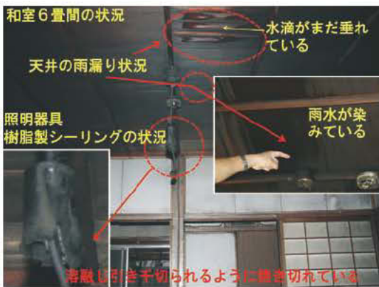
写真3 六畳間天井の雨漏り状況
