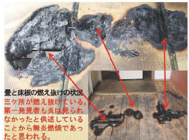
写真11 床の燃え抜けの状況
