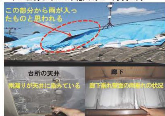
写真2 屋根の状況と雨漏りの状況
