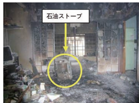
写真1 出火室の状況
