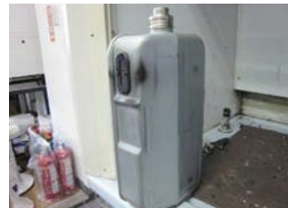
写真19 カートリッジの状況
