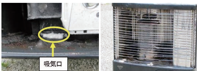
写真13 吸気口の日詰まり状況
