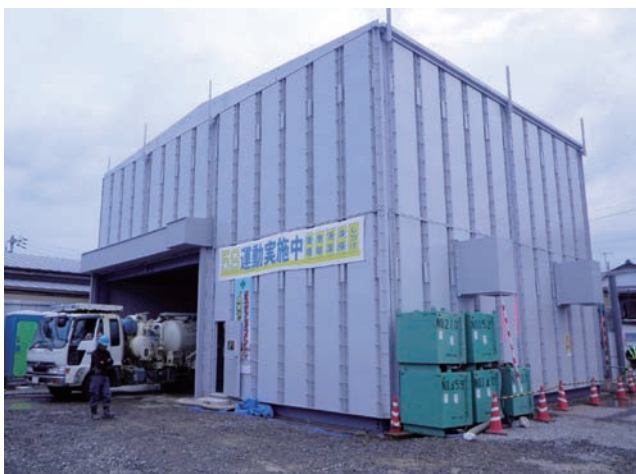
生き埋め事故が発生した下水道敷設工事現場
